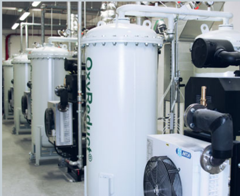
TITANUS® Ansaugrauchmelder (oberes Bild) überwachen die von OxyReduct® (rechtes Bild) geschützten Bereiche
