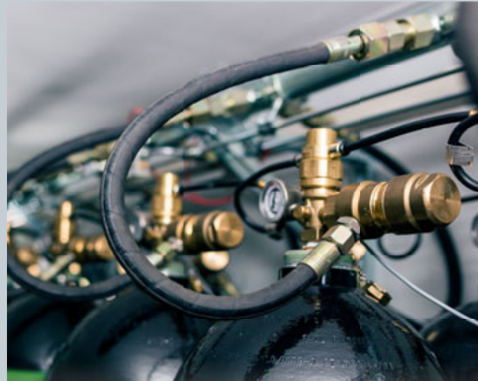
Um Druckspitzen zu Beginn des Löschvorgangs zu minimieren, wurden an den Löschmittelflaschen Durchflussregler angebracht.
