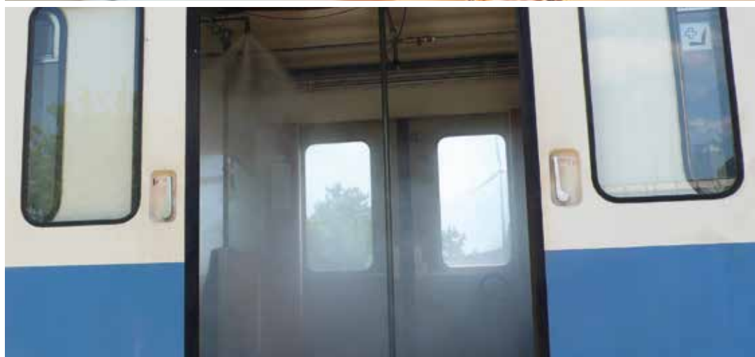
Ausgelöstes Wassernebelsystem im Fahrgastbereich verteilt feinsten Sprühnebel.
