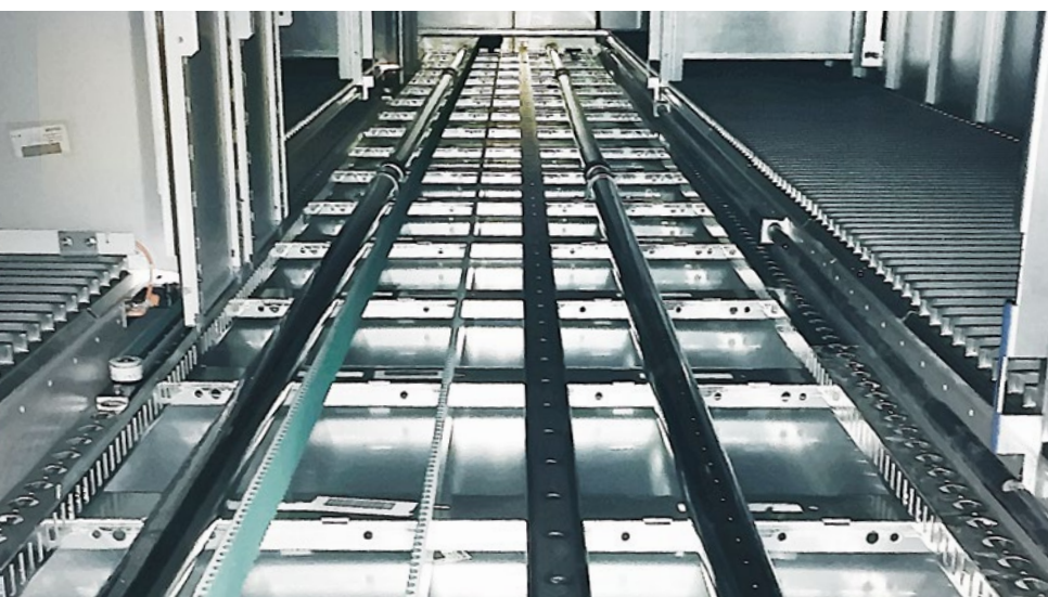
▲ Blickrichtung von unten nach oben: Innerhalb der etwa 12 Meter hohen Lagerlifte befinden sich Diffusorrohre, über deren Öffnungen das Löschgas homogen im Shuttleschrank verteilt wird.
