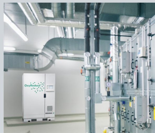
▲ Das Brandvermeidungssystem OxyReduct® sorgt im ehemaligen Tresorraum für eine reduzierte Sauerstoffkonzentration von 15,9 Vol.-%.
