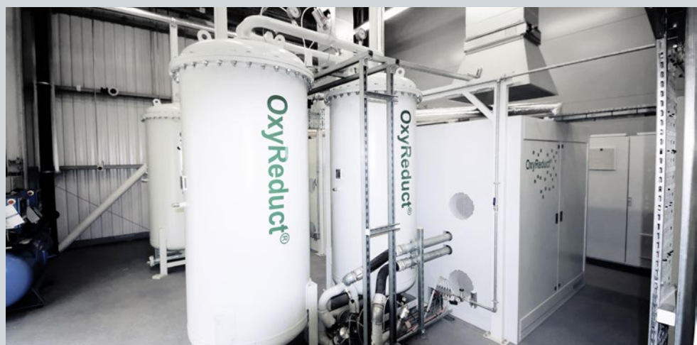
▲ Vier OxyReduct® VPSA-Anlagen sind im Newspaper Storage Building installiert. Sie generieren Stickstoff, mit dem der Sauerstoffgehalt innerhalb des Lagers reduziert wird
