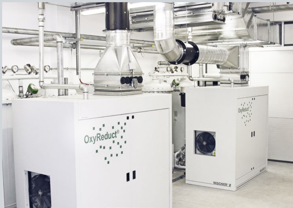
▲ OxyReduct® VPSA schützt das Hochregallager und die eingelagerten Waren vor den Auswirkungen eines Brandes
