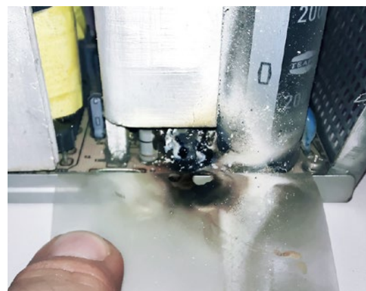
▲ Innerhalb eines Teleprompters ist ein Kondensator durchgeschmort. Das Bauteil ist nicht größer als ein Daumennagel, hätte unbemerkt brennend aber den ganzen Technikraum zerstören können
