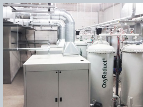
▲ Im Tiefkühlager von KLM wurden drei VPSA-Anlagen mit jeweils einer Liefermenge von ca. 240 m 3 /h Stickstoff verbaut. Eine Anlage wird als Anforderung des Notfallkonzeptes redundant betrieben
